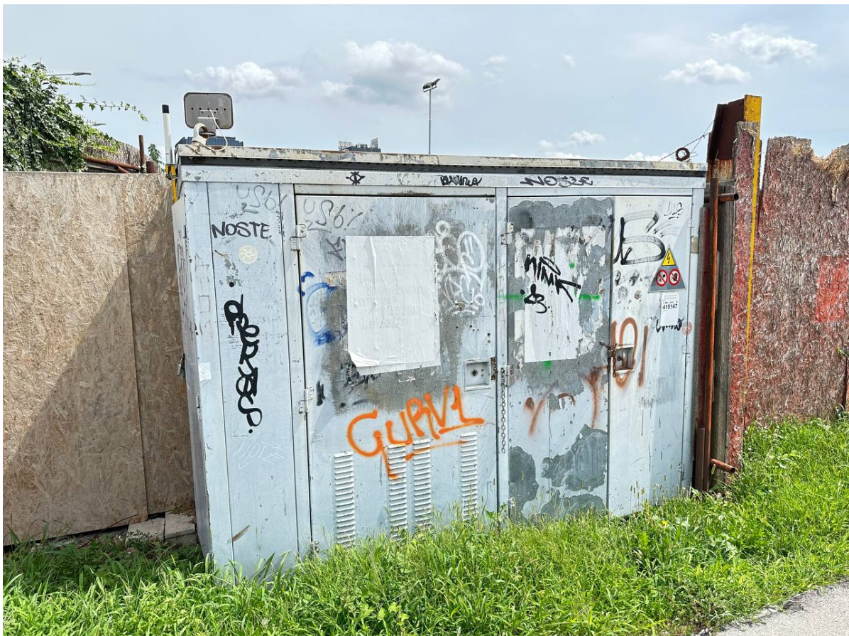
Foto 8 – vista cabina Enel esistente in affaccio su via Venezia
