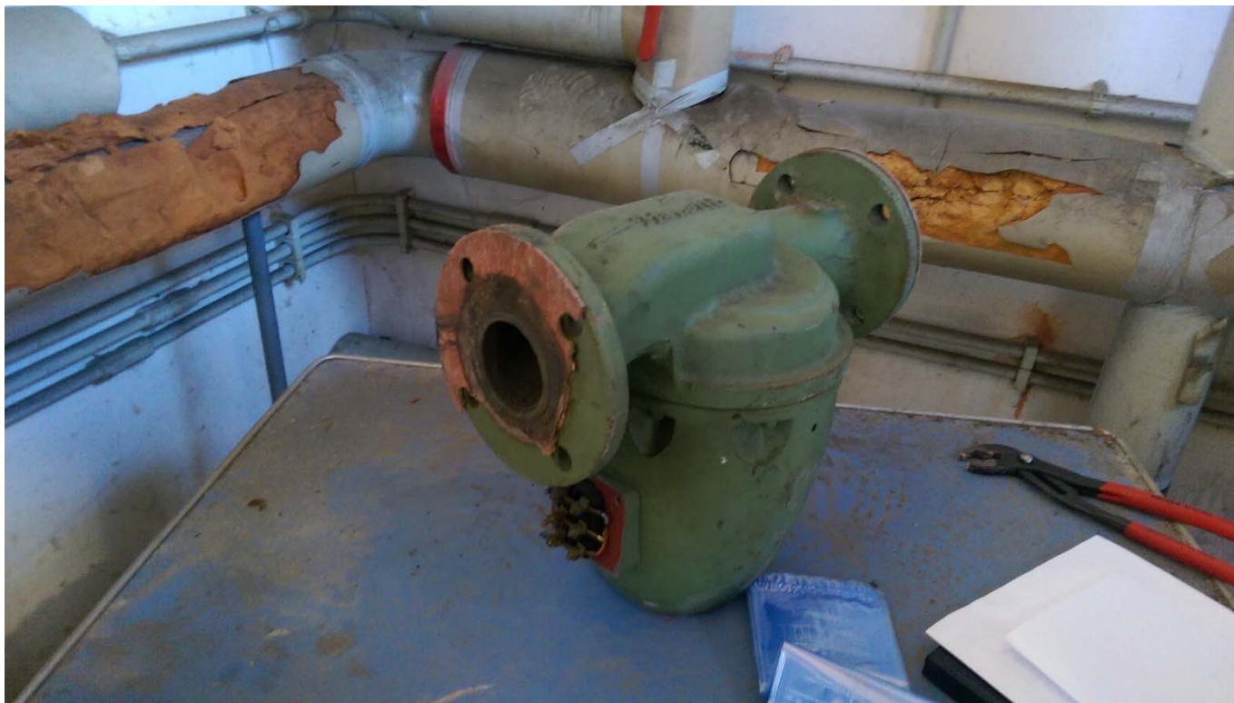
Campione C.15 centrale termica n. 6 – pompa calore
