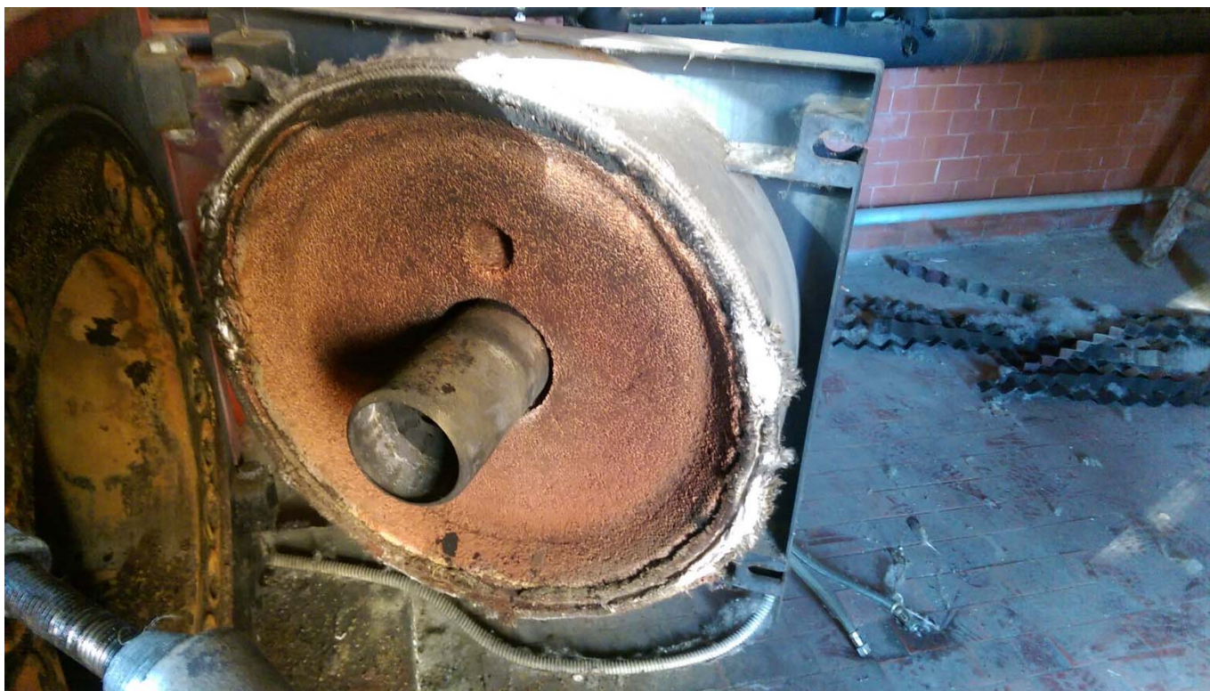
Campione C.11 centrale termica n. 10 – guarnizione caldaia
