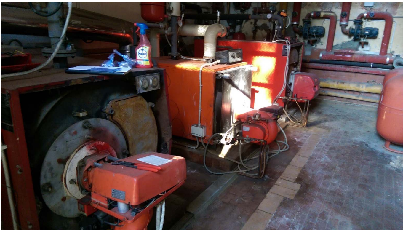
Campione C.14 centrale termica n. 6 – guarnizione caldaia
