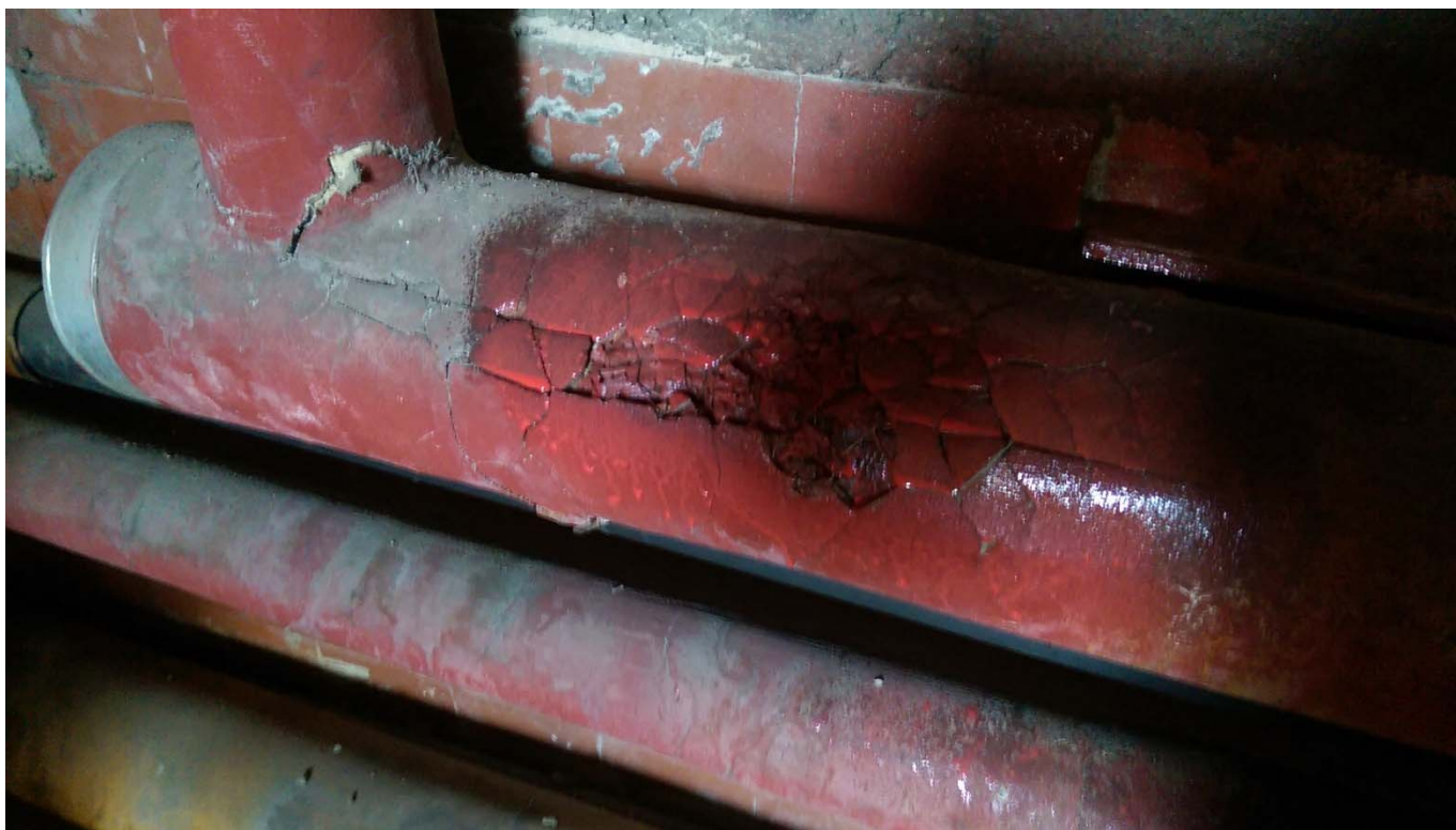
Campione C.13 centrale termica n. 1 – rivestimento tubazione
