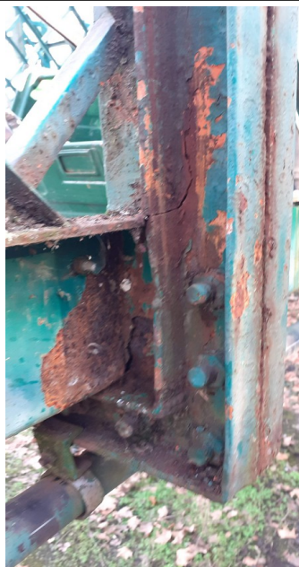
Elementi principali verticali; Sfogliatura della vernice, ossidazione, riduzione della sezione, filtrazione e gocciolamento; Fessurazione
