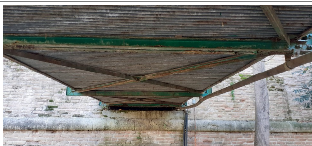
Elementi principali orizzontali; Sfogliatura della vernice, ossidazione, riduzione della sezione, filtrazione
