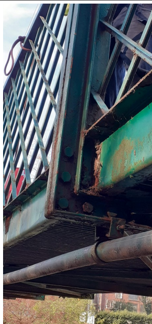
Elementi principali verticali; Sfogliatura della vernice, ossidazione, riduzione della sezione, filtrazione e gocciolamento.
