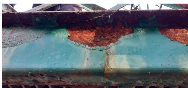
Elementi principali orizzontali; Sfogliatura della vernice, ossidazione, riduzione della sezione, filtrazione e gocciolamento.
