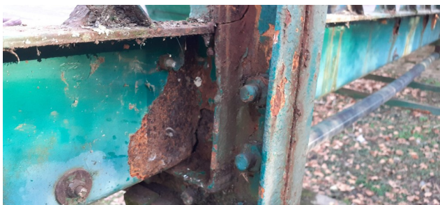
Elementi principali orizzontali e verticali; Sfogliatura della vernice, ossidazione, riduzione della sezione, filtrazione e gocciolamento.
