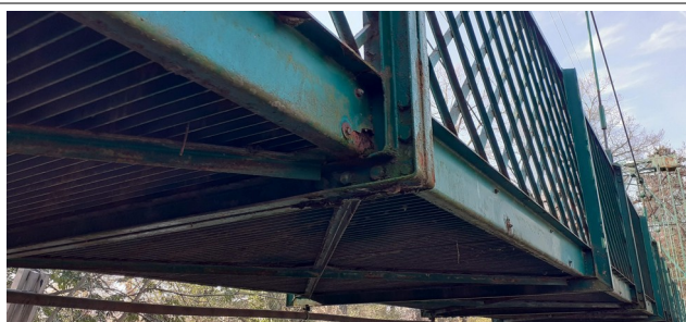
Elementi principali orizzontali e verticali; Sfogliatura della vernice, ossidazione, riduzione della sezione, filtrazione
