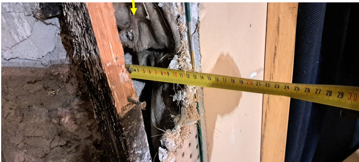
Foto 13 – Stratigrafia dei rivestimenti da rimuovere in prossimità dello spigolo da demolire su proscenio torre scenica
