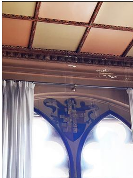
Figura 5-12 Velinature su uno stemma particolarmente deteriorato.
