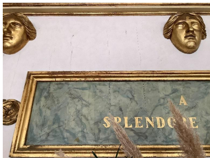
Figura 2-17 Parte bassa del palco. In particolare nel riquadro a colore scuro si osservano fenditure verticali e parallele che suggeriscono il movimento di un supporto profondo probabilmente in legno.
