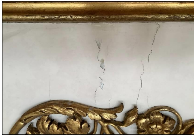
Figura 2-15 Particolare dell'esterno della parte bassa del palco. Sfogliature della tinteggiatura e fessurazioni dello strato sottostante.
