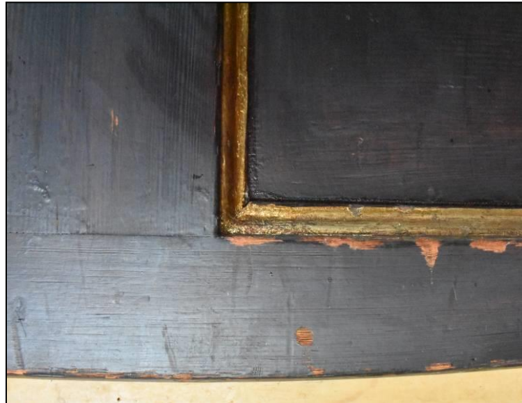
Figura 2-5 Abrasioni su tinteggiatura scura dei serramenti.
