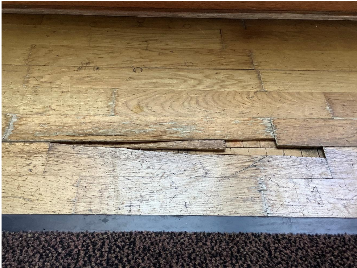
Foto II.3.52 – Particolare di pavimentazione della Sala Egizia: mancanze consistenti dei listelli che mettono in luce il sottofondo
