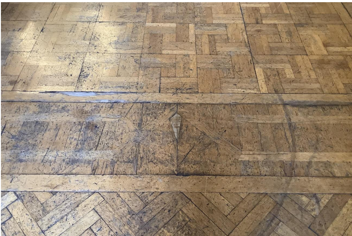
Foto II.2.27 e II.2.28 – Sala Rossini: particolari dell'attuale pavimento di parquet, databile al 1920-1930 circa: si noti la situazione di gravissimo degrado della superficie
