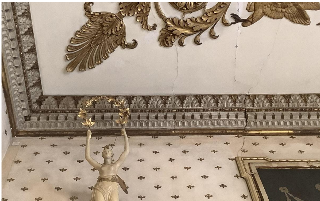
Foto II.2.20 – Sala Rossini: particolare della ricca modanatura di stucco sagomato a stampo che raccorda la decorazione delle pareti con il controsoffitto. Si notino anche le vistose lesioni strutturali
