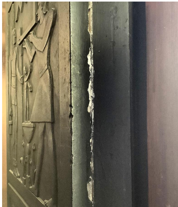
Foto II.3.43 – Sala Egizia, particolare di uno dei bassorilievi della cornice della grande porta-finestra che immette sulla terrazza esterna: si nota un'evidente fessurazione, con scagliature e lacune nella pellicola pittorica superficiale in corrispondenza della cornice interna dell'infisso (in legno)
