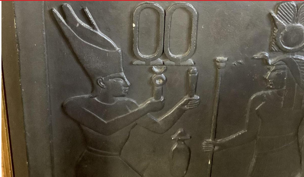
Foto II.3.42 – Sala Egizia, particolare di uno dei bassorilievi della cornice della grande porta-finestra che immette sulla terrazza esterna: si notano alcune piccole lacune nella pellicola pittorica superficiale, dovute probabilmente ad urti accidentali
