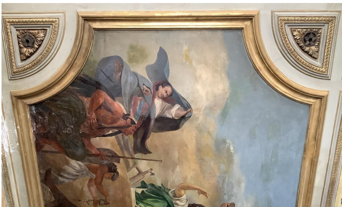
Foto II.4.18 – Controsoffitto della Sala Rinascimentale: la porzione sinistra del dipinto centrale di Vincenzo Gazzotto mostra un certo degrado costituito in particolare da efflorescenze saline
