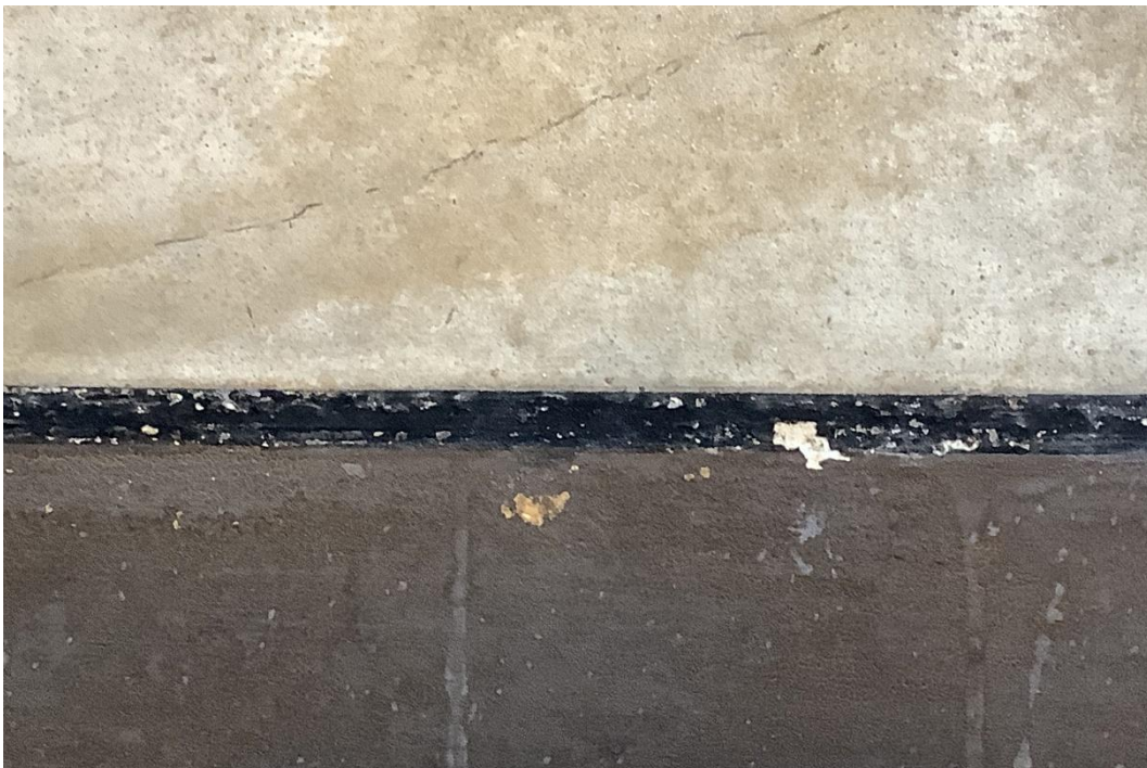
Foto II.5.16 – Vestibolo della Sala Gotica: alcune nella tinteggiatura superficiale della falsa cornice marrone della mappa lasciano trasparire l’intonaco a marmorino della fase di decorazione originaria
