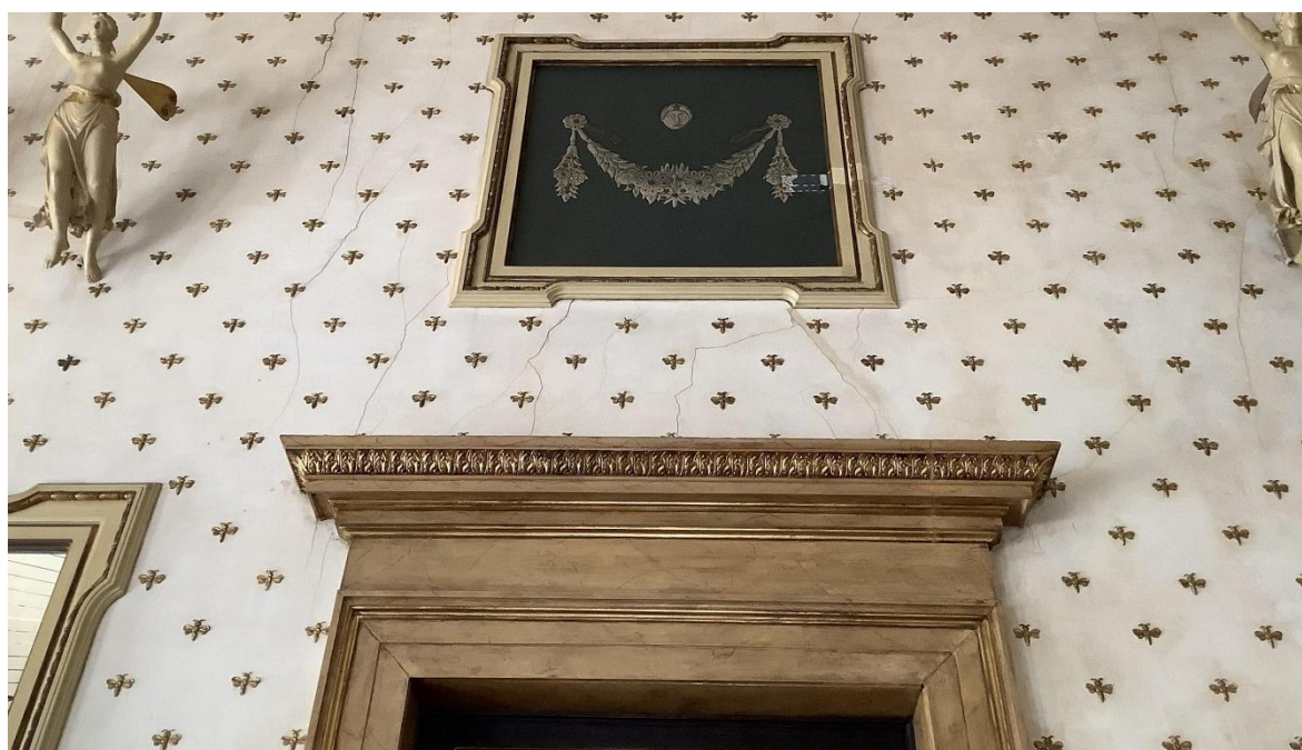
Foto II.2.5 – Sala Rossini: particolare della cornice con trabeazione (decorata da motivo di palmette dorate) di una delle porte di collegamento con gli ambienti adiacenti. Si noti anche l’esteso quadro fessurativo
