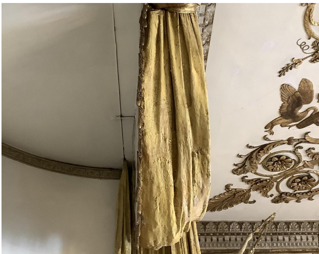
Foto II.2.47 – Sala Rossini, particolare del finto sipario di juta gessata e dipinta: si notino le piccole lacune, esfoliazioni e distacchi della pellicola pittorica e/o del relativo strato preparatorio, e gli accumuli localizzati di deposito superficiale
