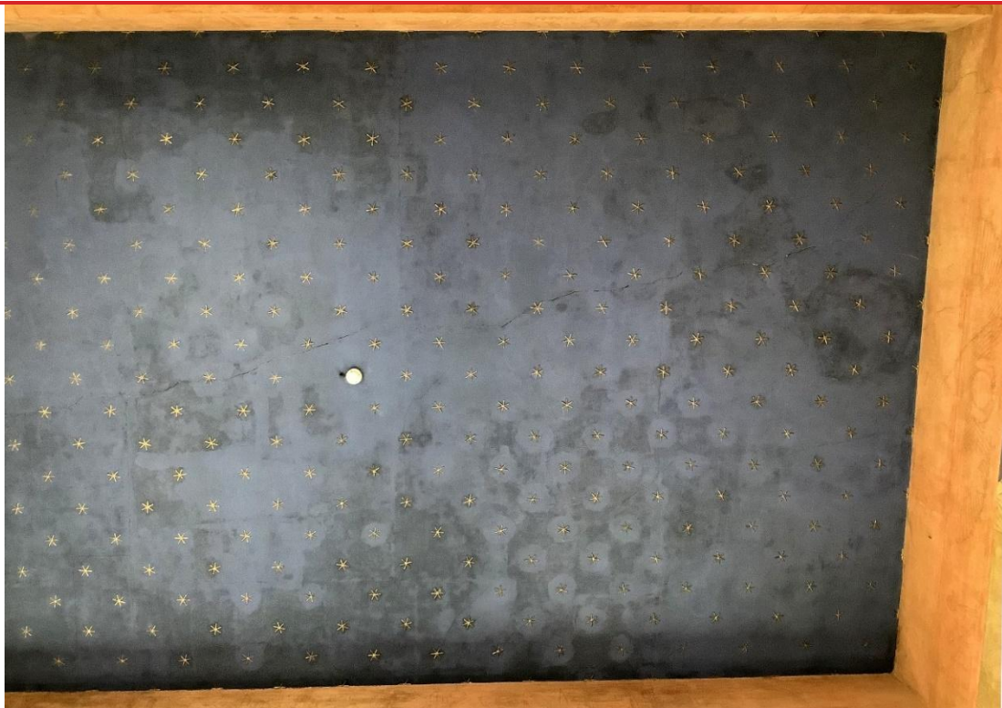
Foto II.3.35 – Sala Egizia, vista d’insieme del controsoffitto con il cielo di stelle d’oro: si notino le numerose macchie e aloni di umidità dovuti a infiltrazioni d’acqua
