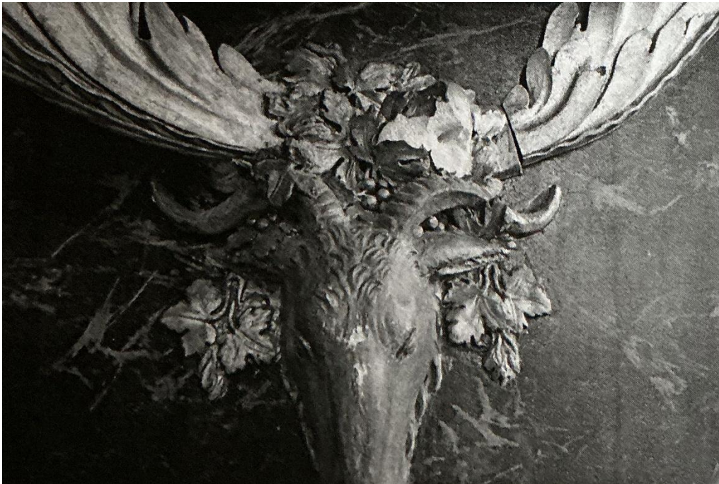
Fig. 1.4.7 – Particolare dei danni subiti nel 2015 da una delle teste di montone in stucco dorato nella porzione inferiore di una delle specchiere della Sala Rinascimentale. Foto tratta dalla relazione del 2017 a firma del restauratore incaricato dell'intervento, Roberto Bergamaschi.
