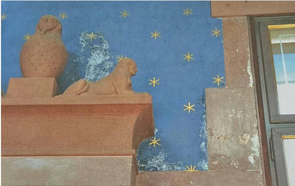
Fig. I.3.5 – Particolare del degrado delle pareti della Sala Egizia nel 2011, subito prima degli interventi di restauro progettati ed eseguiti da Francesca Faleschini, dalla cui relazione è tratta l'immagine.
