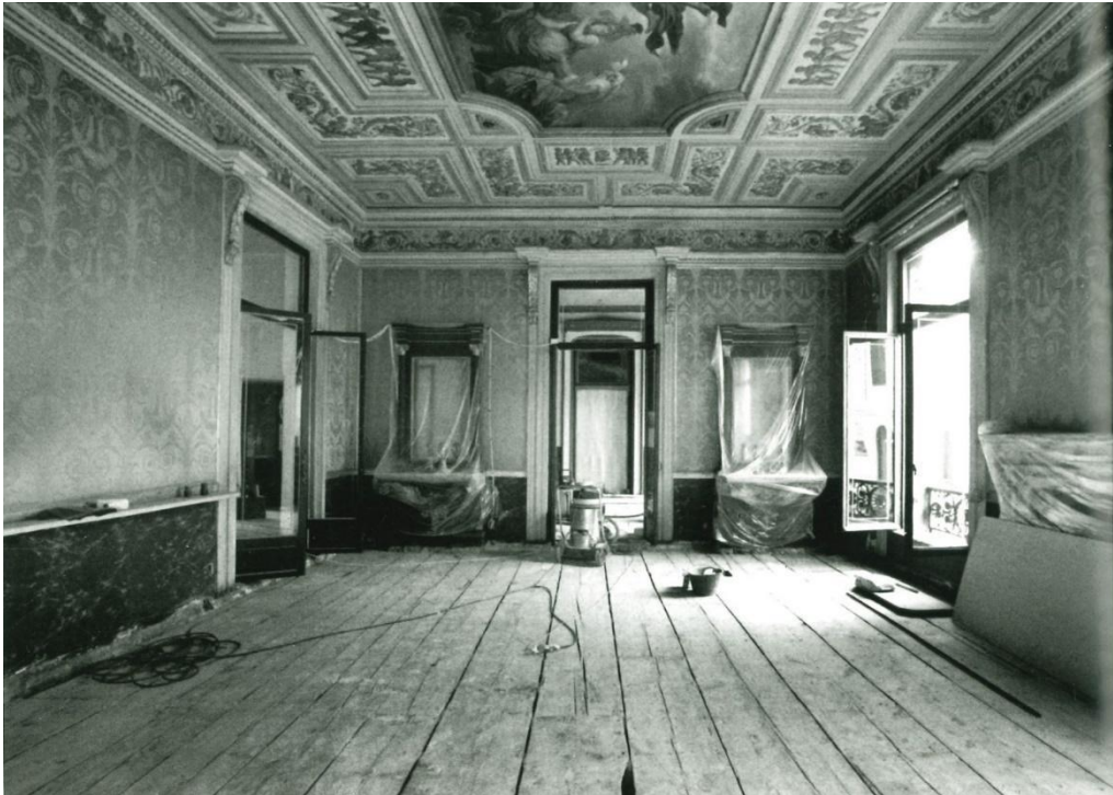
Fig. 1.4.6 – La Sala Rinascimentale durante il restauro strutturale del 1994-1999: la rimozione del pavimento ha rivelato l'estradosso del tavolato strutturale del solaio del primo piano. Tratto da Il Caffè Pedrocchi. La storia, le storie , op. cit., pagina 202.
