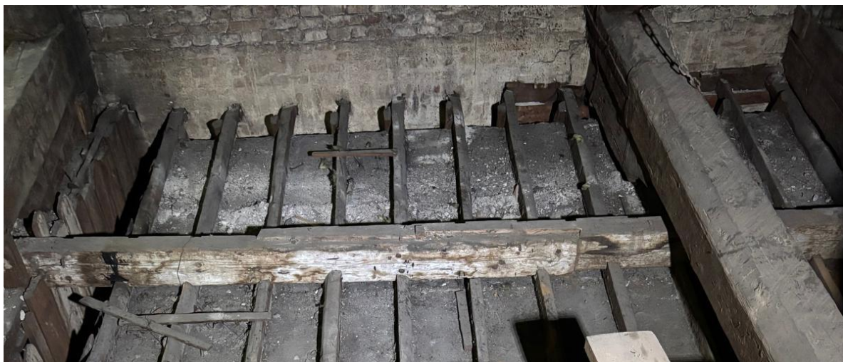
Figure 9 - Travi principali del sottotetto giuntate con sistema a Dardo di Giove; presenza di "tacche" sulla trave.
