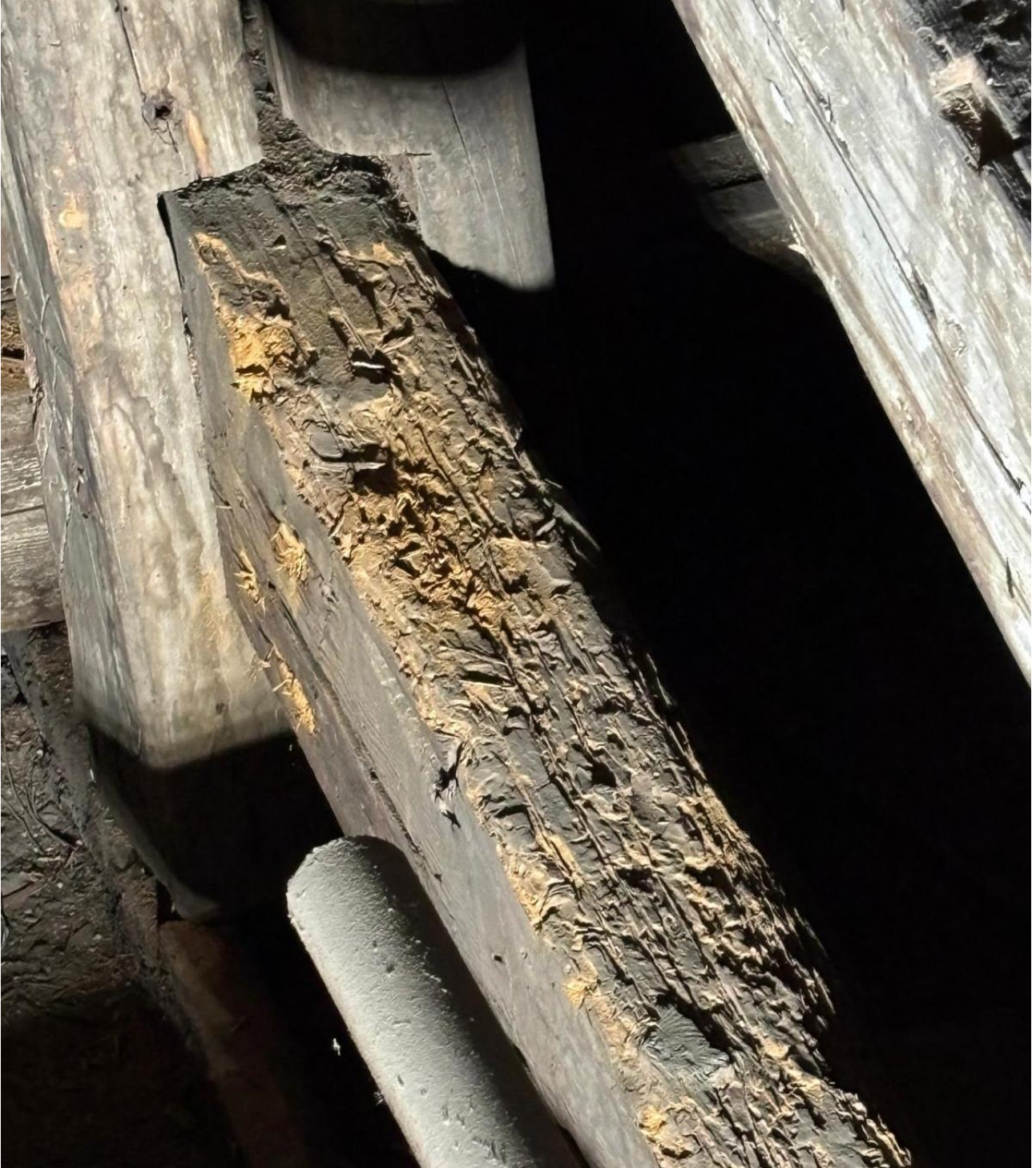
Figure 20 - deterioramento dell'alburno nella catena della capriata CP7
