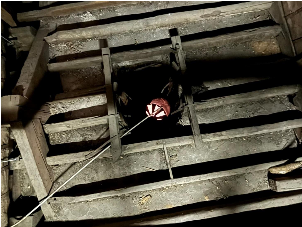
Figure 17 - A sx la sommità della capriata a sostegno del sipario del palcoscenico; al centro il foro di areazione dell'antico impianto di illuminazione a gas del palcoscenico
