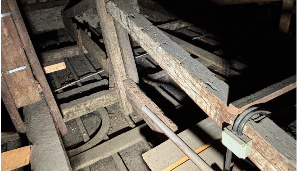
Figure 11 - Presenza di elemento ligneo a forma circolare appartenente al sistema del secondo ordine di travicelli a sostegno del plafone.
