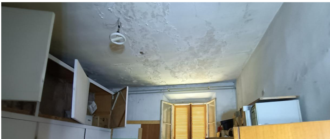
Vista di alcune delle zone che presentano infiltrazioni
